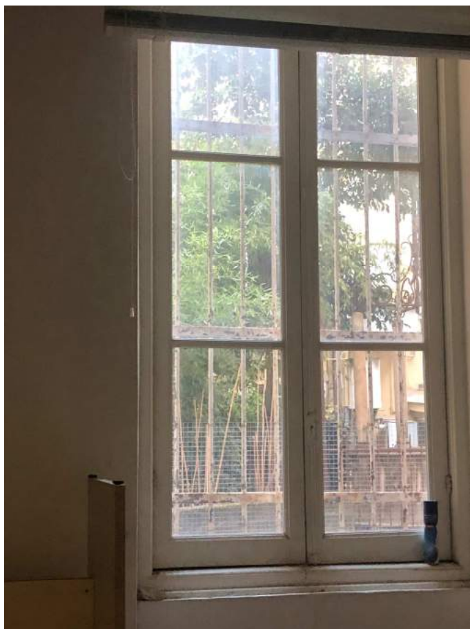
Inferriate e serramenti da ripristinare
