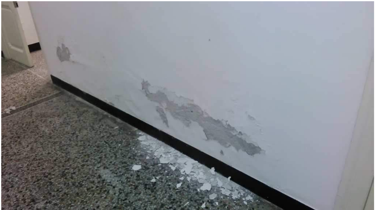
Esempi di intonaco in fase di distacco
