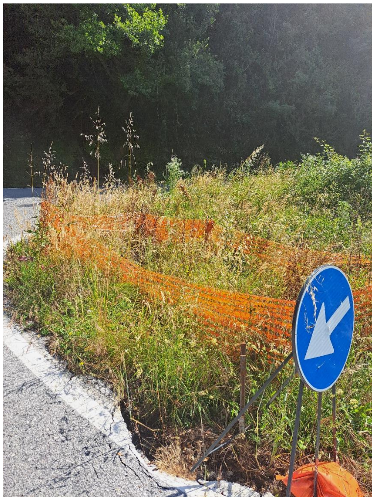
FOTO 2: zona recitata a causa del danneggiamento della tubazione esistente
