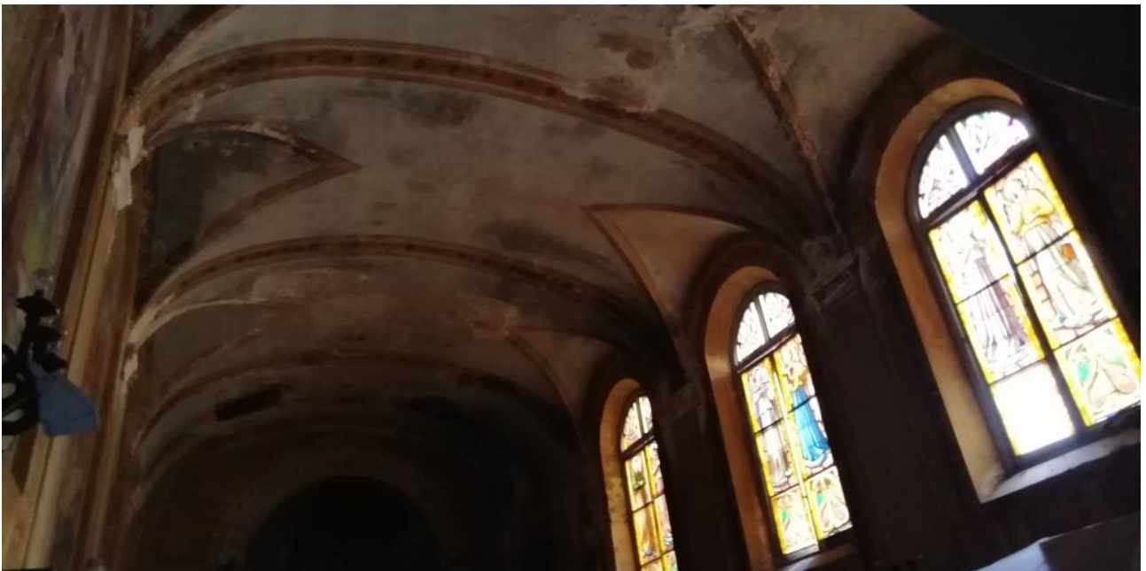
Foto n° 4 – degrado affreschi volte e finestre
