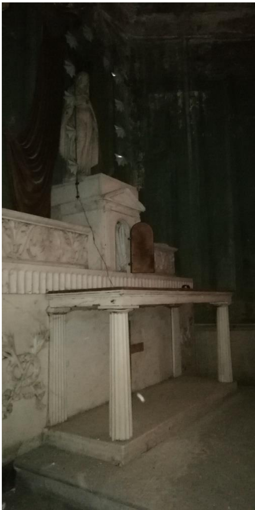
Foto n° 6 – degrado zona altare
