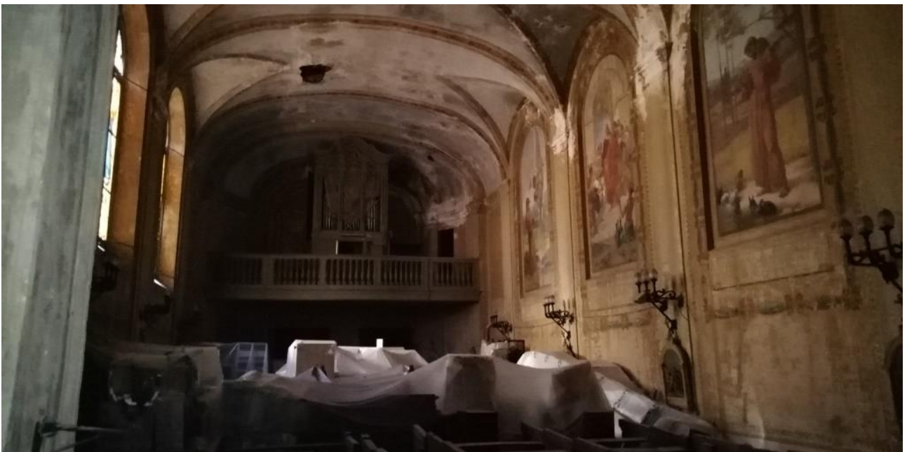
Foto n° 2 – degrado affreschi pareti e volte cappella
