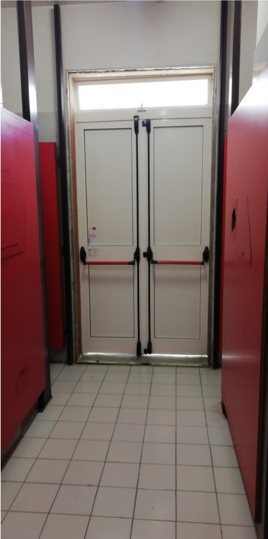
Foto n° 1 – maniglioni esistenti da smontare e riposizionare su porte bagno previa installazione nuova porta REI
