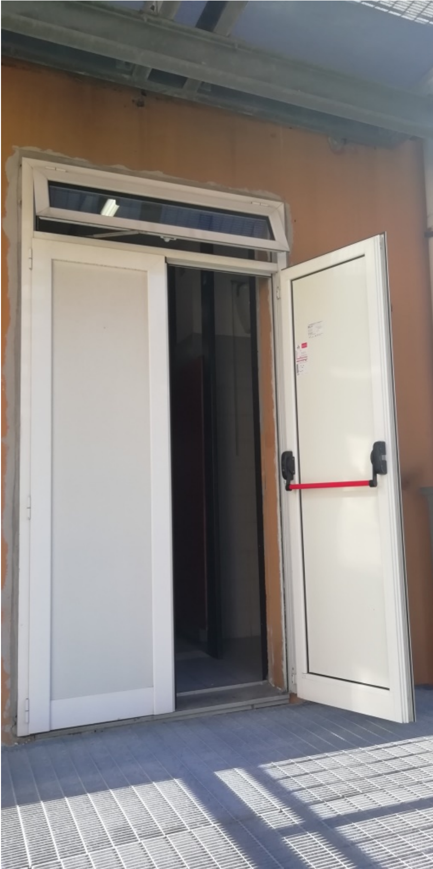
Foto n° 3 – porte esterne da sostituire con nuove porte rei per difesa via si esodo
