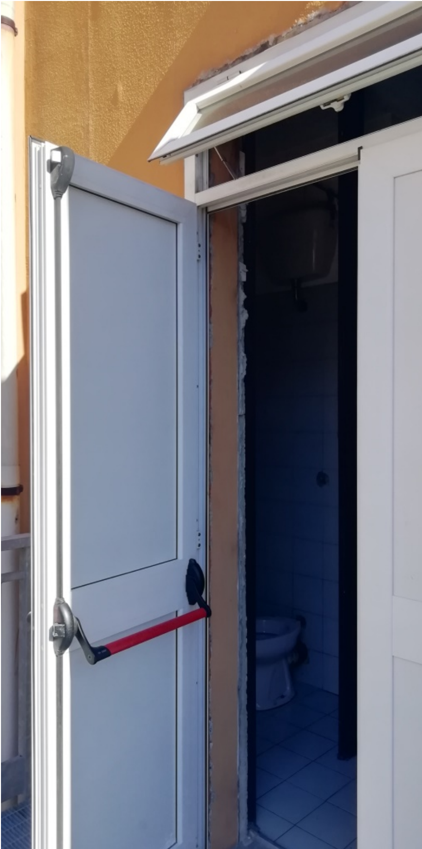
Foto n° 4 – porte esterne da sostituire con nuove porte rei per difesa via si esodo
