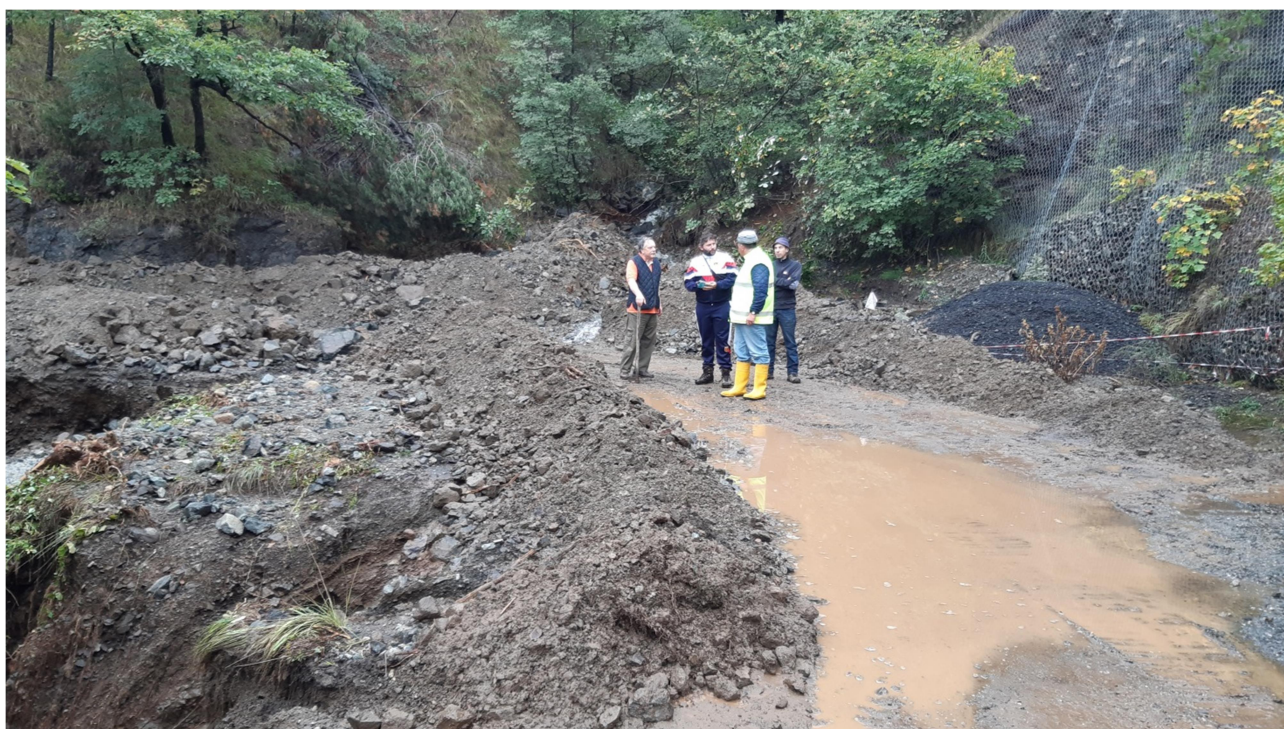
Vista detriti sul piano rotabile dopo alluvione, reti paramassi ricolme di detriti, piattaforma, rete di smaltimento acque captate sulla strada e barriera marginale distrutta
