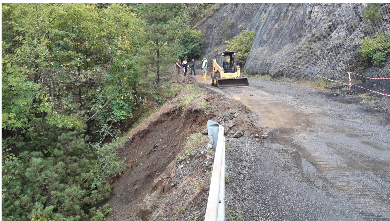
Vista ciglio scarpata area intervento post alluvione (ripresa in direzione da Olbicella verso Tiglieto)
