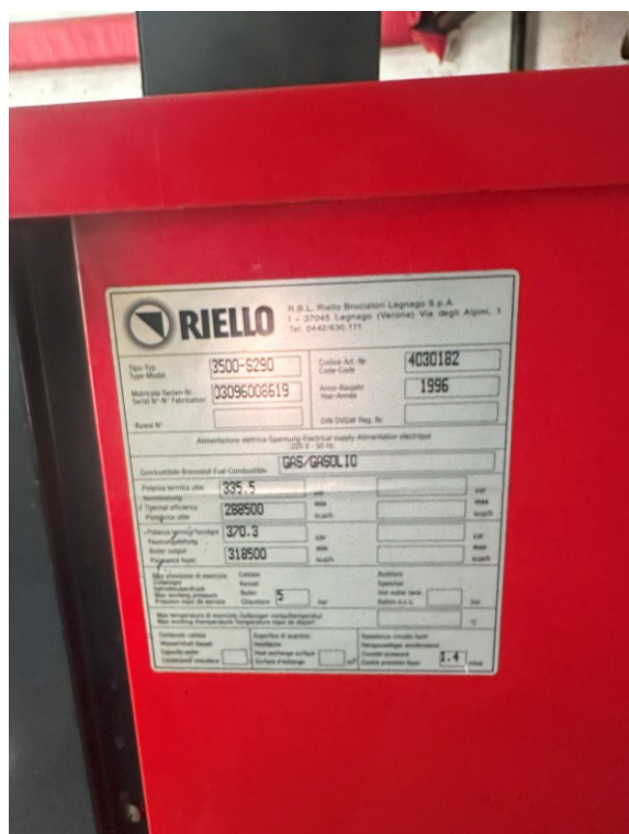
Figura 13. Targa della caldaia esistente
