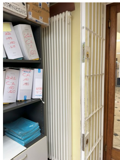
Figura 19. Radiatori in acciaio
