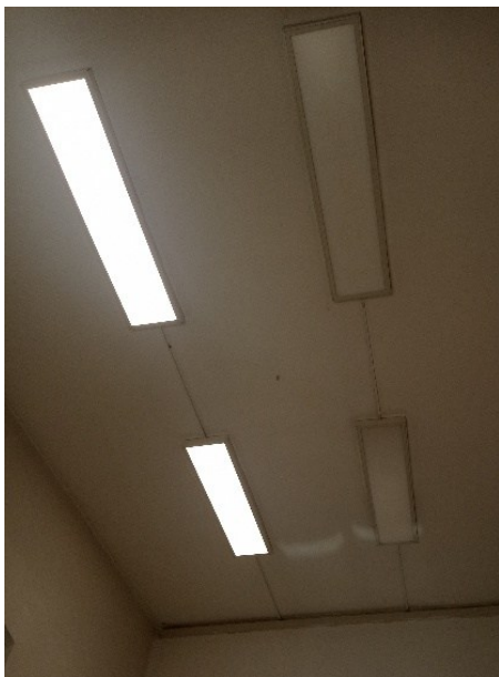
Figura 26: Lampade LED esistenti
